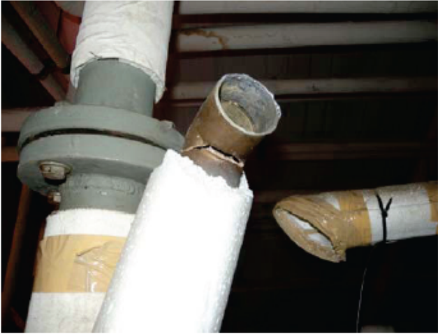
شکل ۲: شکستگی لوله متصل به دیگ بخار، بیمارستان سن‌کارلوس، زلزله ۲۰۱۰ شیلی
